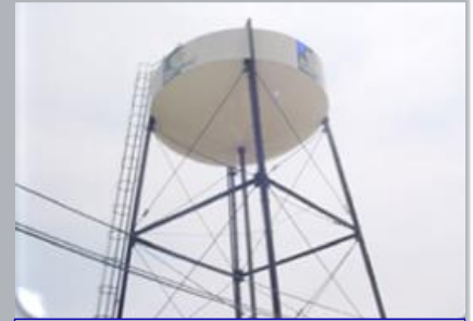
Tanque elevado de acero
